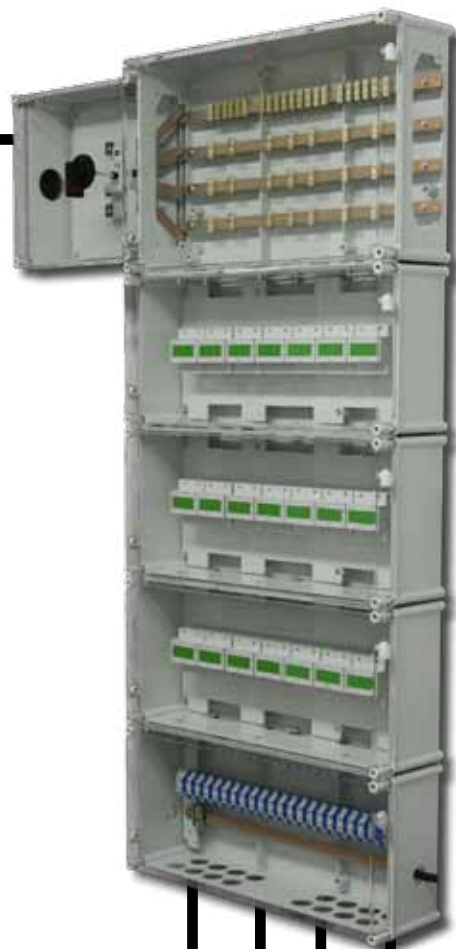
Centralización Contadores Secundarios
