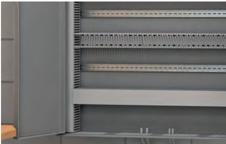
Los carriles DIN se utilizan en armarios de distribución.
