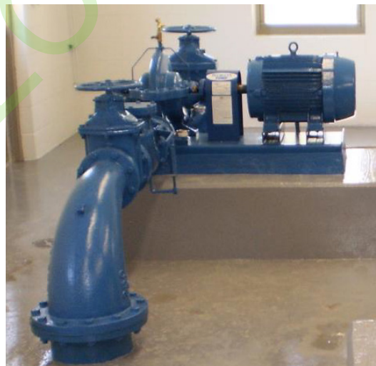
Figura 2. Sistema de bombeo de aguas pluviales
