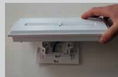
Retirar la luminaria
